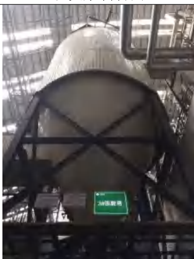
焚烧炉烟气处理-脱酸塔
