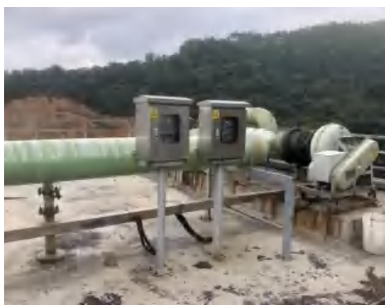
臭气密闭收集装置
