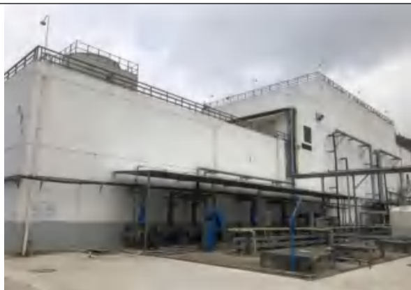
高浓度污水（垃圾渗滤液）处理系统
