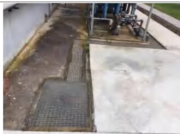
低浓度污水处理设施应急收集槽
