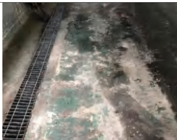
养护间收集沟
