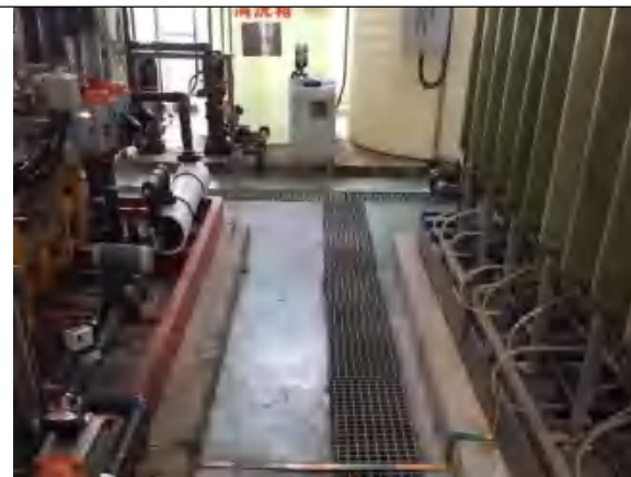
高浓度污水处理设施应急收集槽
