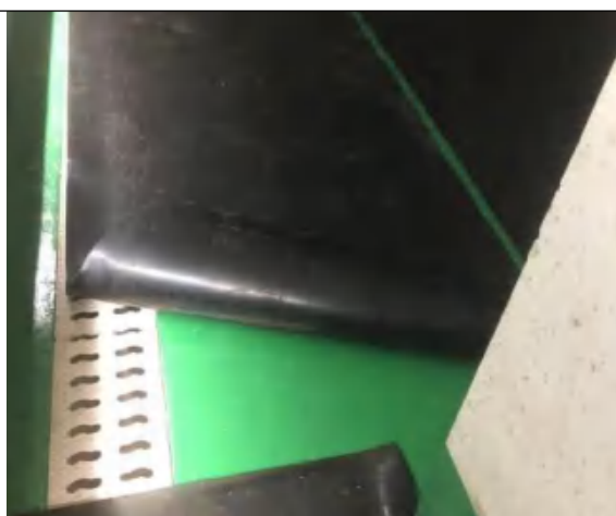
危废间防渗及收集
