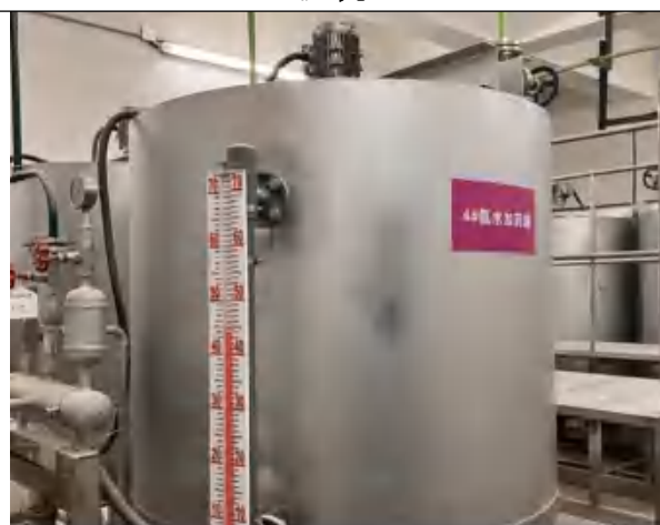
化水间氨水罐
