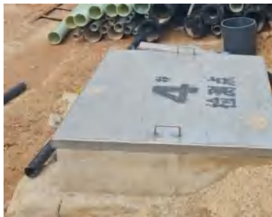
地下水监测井4#
