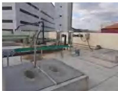
渗滤液调节池（预处理）
