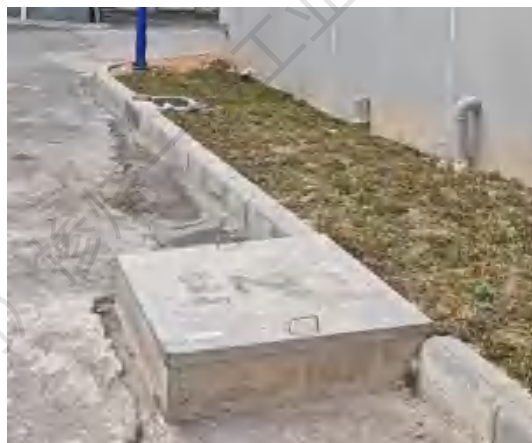
地下水监测井2#
