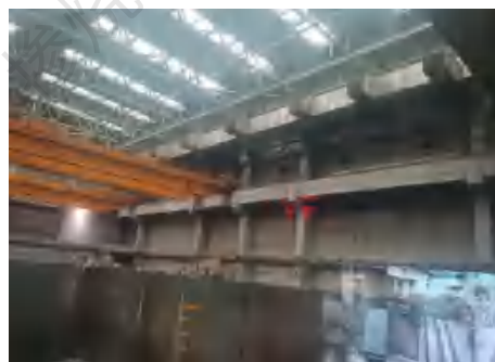
垃圾储坑吸风口
