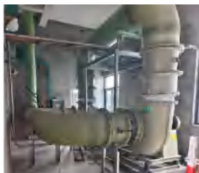
污水处理除臭风机及管道
