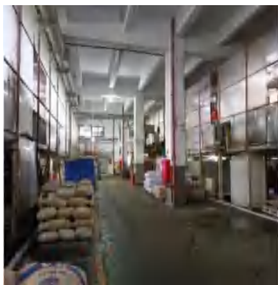
废气收集管道
