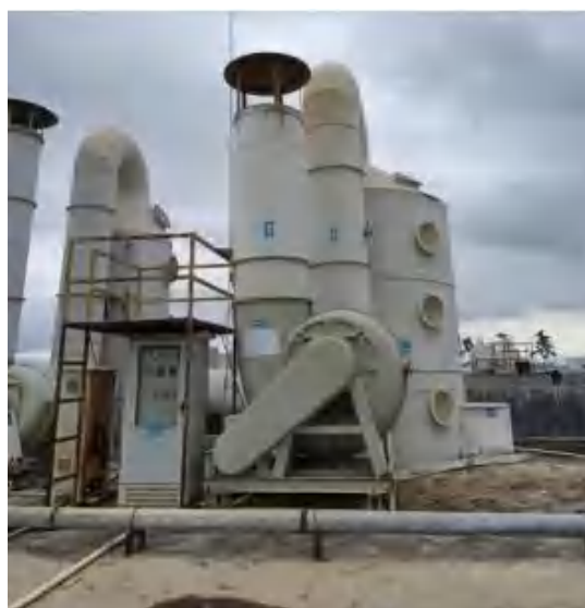
废气处理设施
