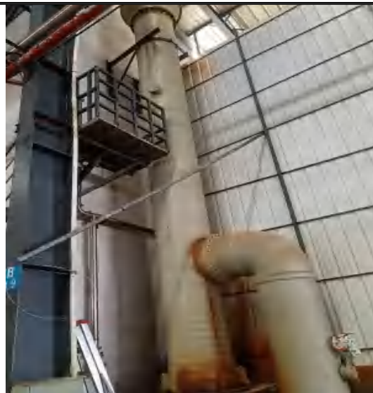
酸雾废气排气筒
