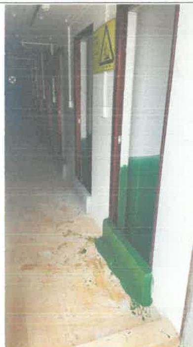
现场危废间、一般固废间围堰设置
