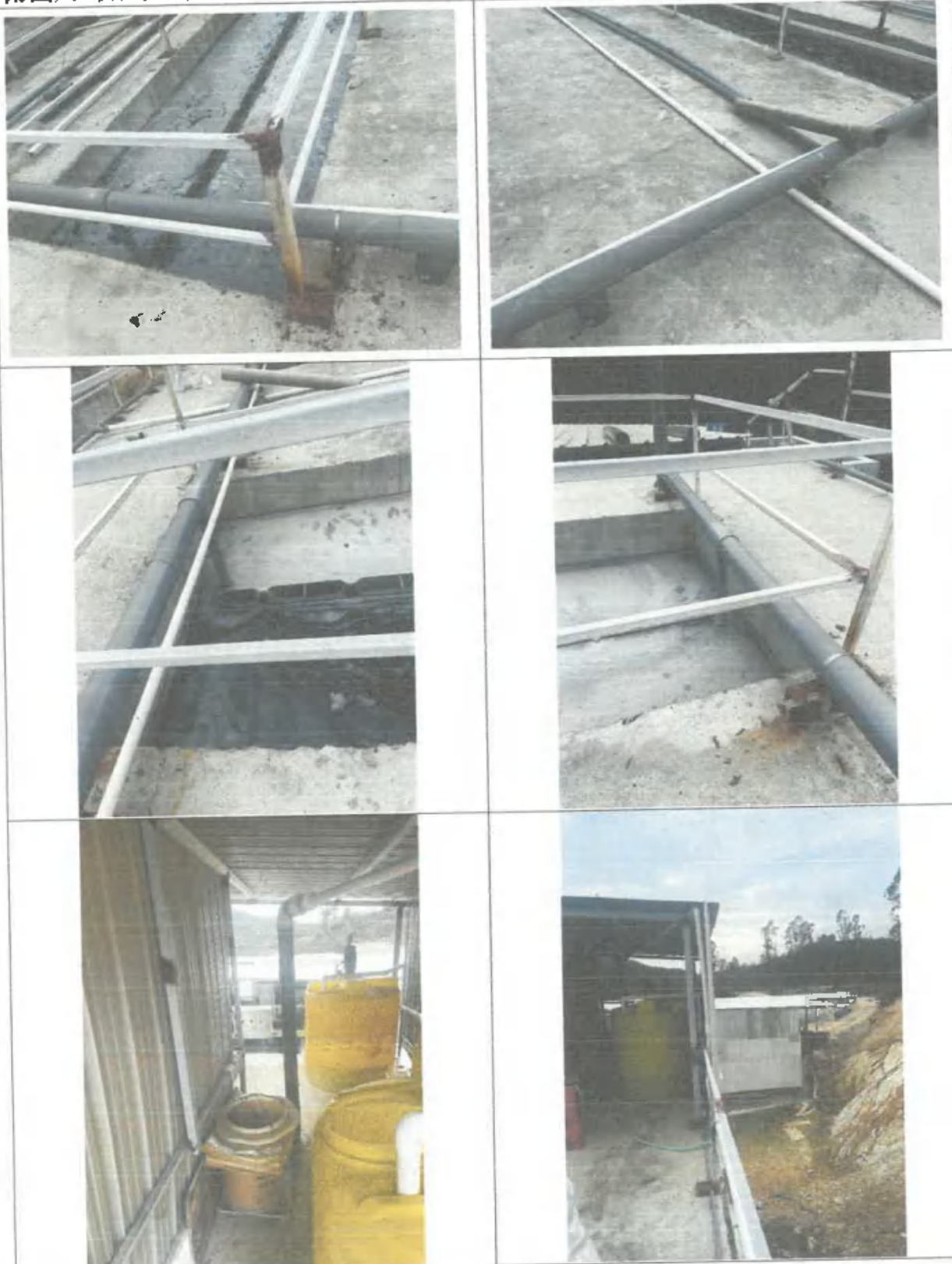
污水处理站沼气收集管道
