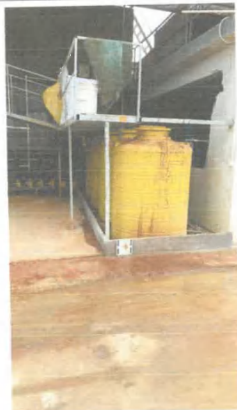
现场加药罐存放区围堰设置
