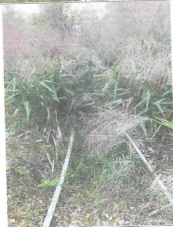
灌溉回用水輸水管道
