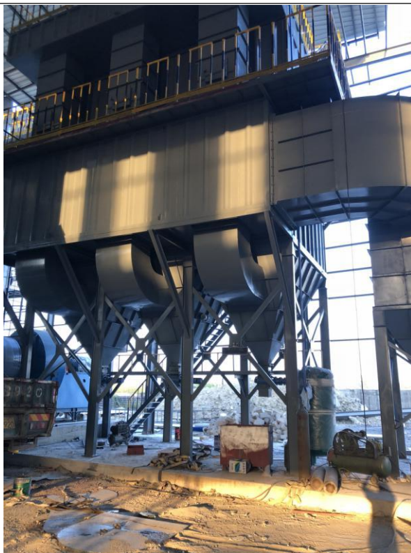
废气处理设施
