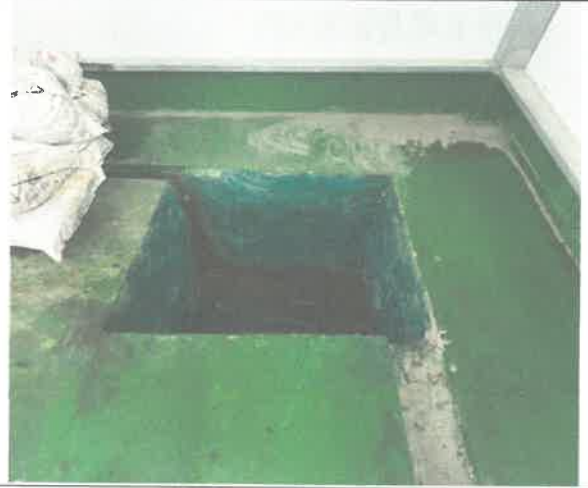
危废间（集水池）
