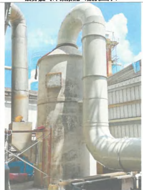
碱雾净化塔（除油清洗）
