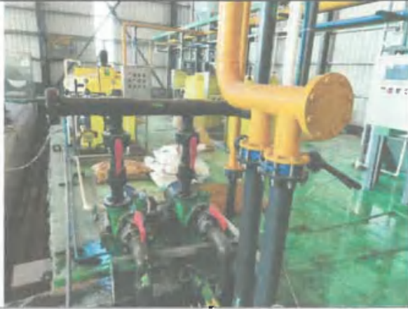
废水处理设施
