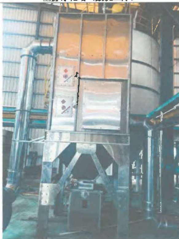
布袋除尘器（破鳞工序）
