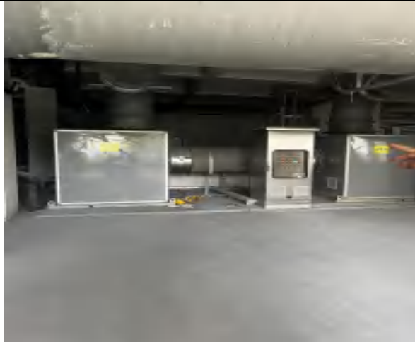
现场除臭设施
