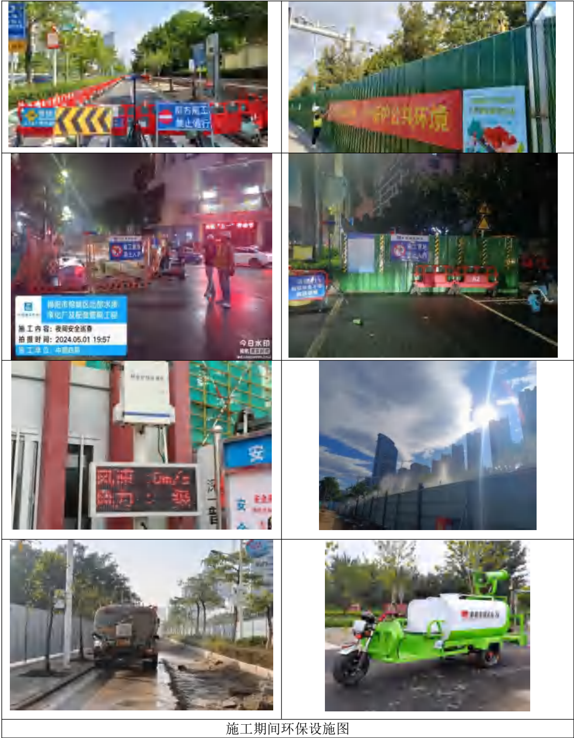
附图 1 项目配套管网工程施工期及完工后环保设施图片
