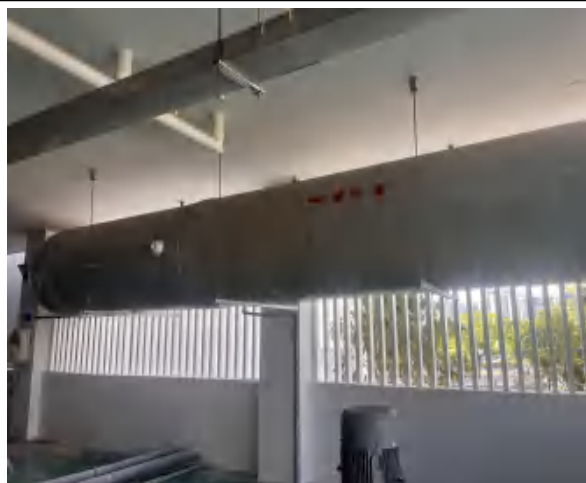
废气管道连接天面排气筒
