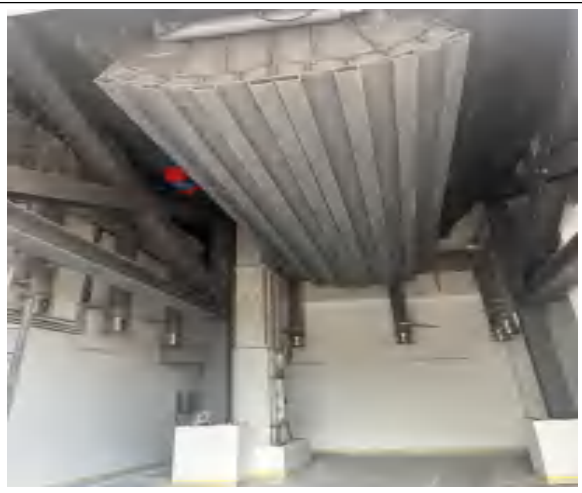
污泥脱水设备
